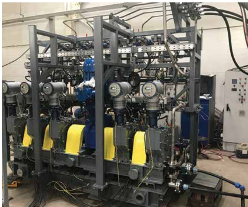
Система дозирования метанола в скважины и шлейфы. «Газпром ПХГ» г. Волгоград.
