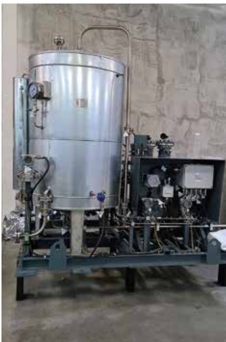
Система дозирования присадок в топливо. «Газпромнефть - Московский НПЗ» г. Москва.
